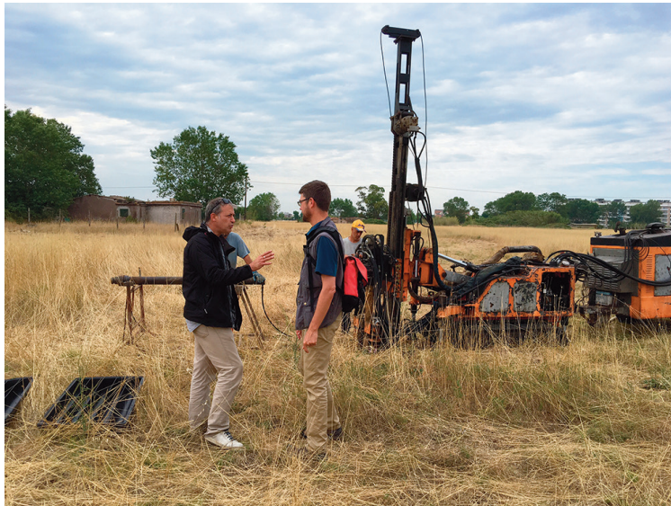
Photo des opérations de carottage en cours / Foto delle operazioni di carotaggio in corso (Photo L. Guinebault).
