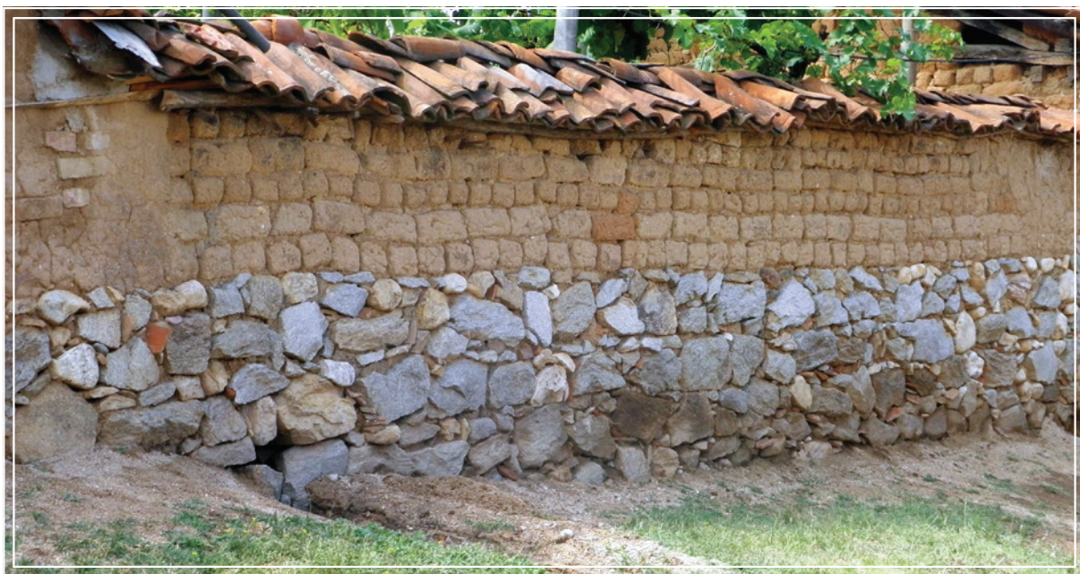
I.4.3a. Съвременна оградна стена с използване на кирпич Contemporary enclosing wall with adobe
