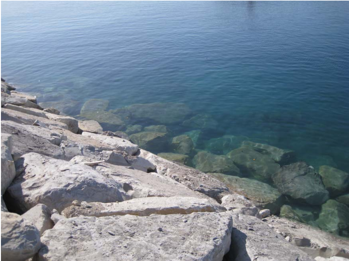
Photo no. 1 – Sous couche de la digue Nord côté interne - La ligne du talus de la sous couche ne semble pas régulière.
