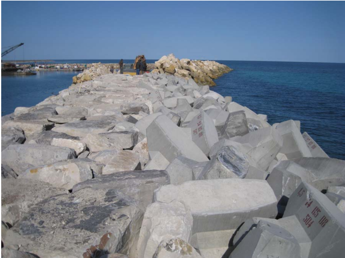
Photo no. 9 - Digue Nord - Blocage de la dernière ligne de blocs ACCROPODE™ par des enrochements
