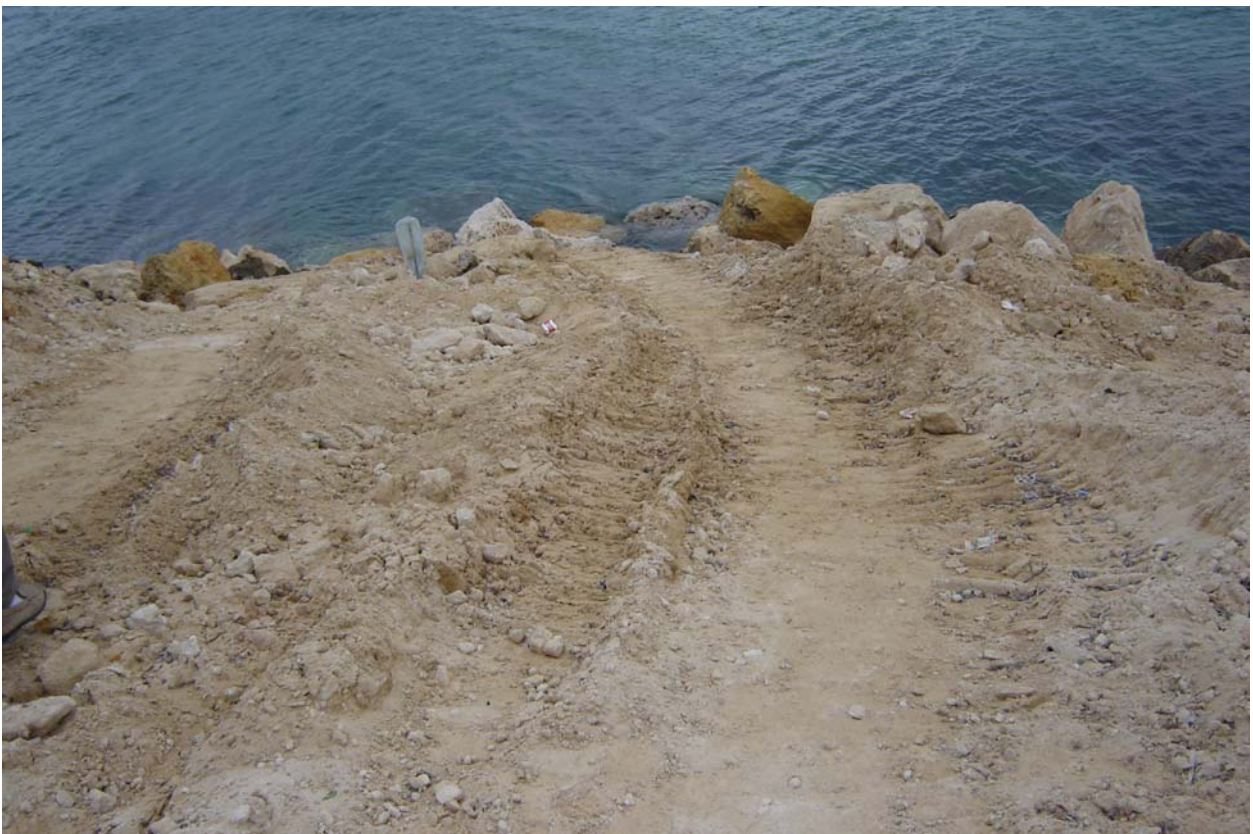
Photo N° 14 : Enracinement Digue Nord
